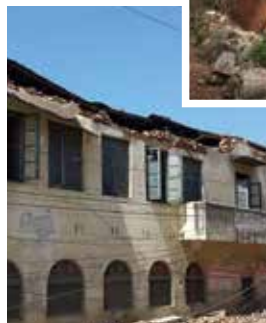
建物の復旧には時間がかかりそうです
